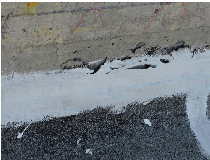
Φωτογραφία 2 Ρηγματώσεις δοκών
